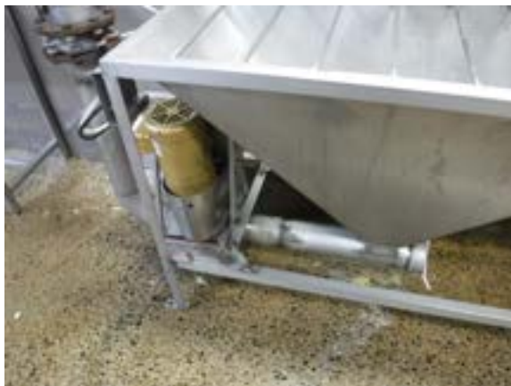
Conserte os vazamentos para conter o material orgânico e a água. Os microrganismos precisam de vazamentos para sobreviver.
